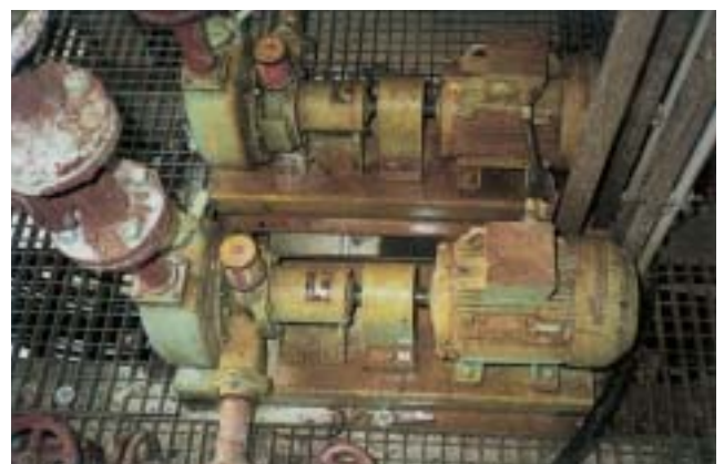
Pumpen J30-180 für die Dosierung von Neutralisierungslösungen
