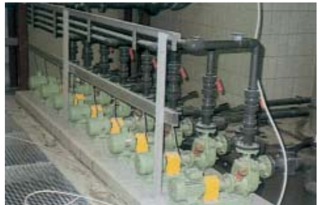
Reihe Pumpen J40 aus rostfreiem Stahl in einer Kläranlage
