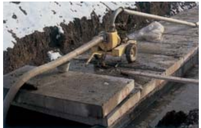
Pumpe J156-5, verwendet als Bypass für Abwässer
